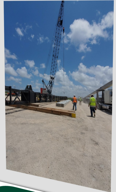
22-512 PLNG GIS SUBSTATION
